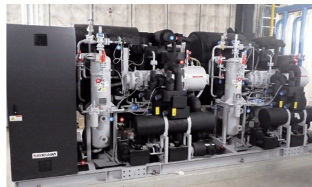
自然冷媒を使用した冷凍機(キョクヨー秋津冷蔵(株)福岡事業所)
