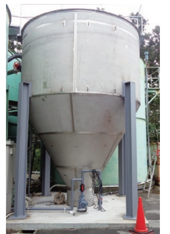
増設した極洋食品(株)ひたちなか工場の沈殿槽
