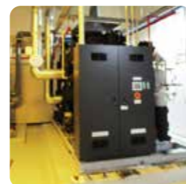
新設されたノンフロン冷凍機
