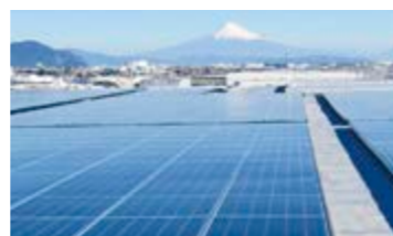
冷蔵庫屋上の太陽光パネル
