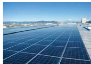
冷蔵庫屋上の太陽光パネル
