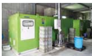
生ゴミ処理機全景(2台あります)
