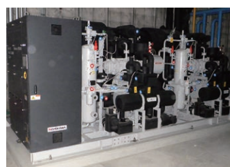
ハイブリッド方式の冷凍機外観
