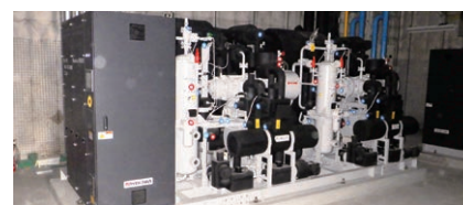
自然冷媒を使用した冷凍機 (キョクヨー秋津冷蔵(株)福岡事業所)
