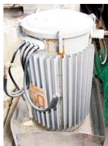
あと1台残って保管中の低濃度PCB含有のトランス(極洋食品(株)八戸工場)
