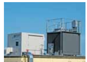
冷凍保管庫屋上に設置した冷凍機
