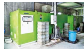
生ゴミ処理機全景(2台あります)
