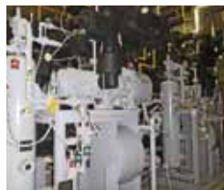
新たに導入した冷凍機
