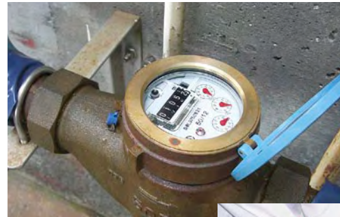
新たに設置した流量計
